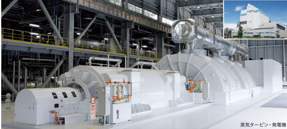
蒸気タービン・発電機
