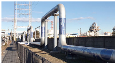
蒸気を供給する配管
