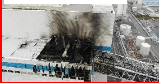
Aバunk付近 爆発による損傷
