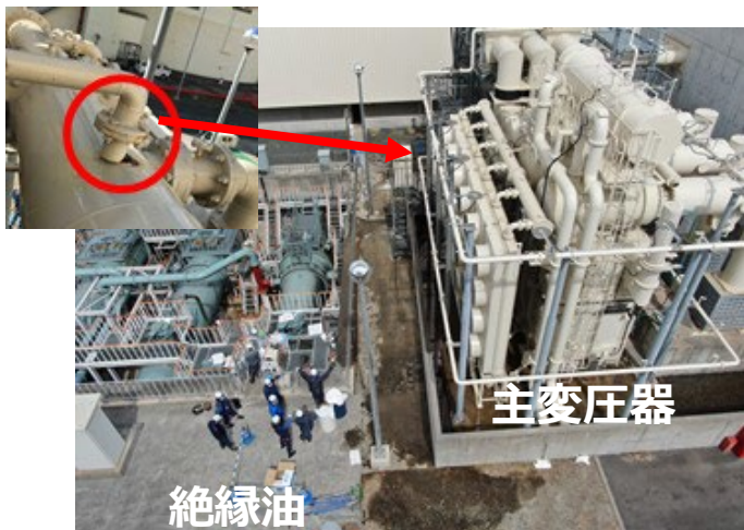
主変圧器絶縁油配管損傷に伴う絶縁油漏洩
