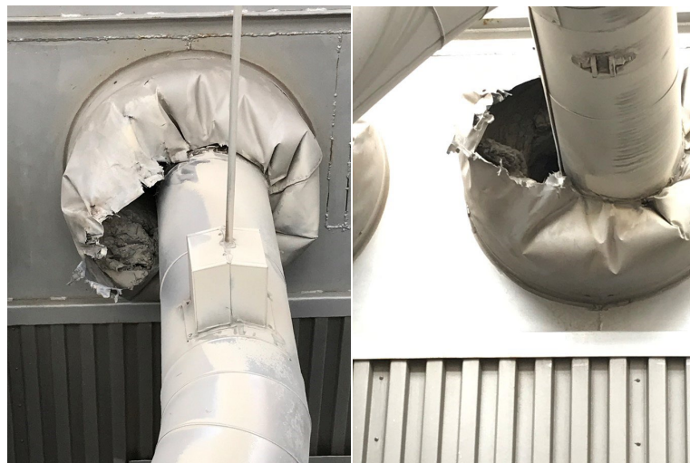
ボイラ配管貫通部伸縮部損傷
