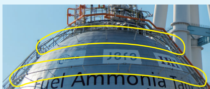
燃料アンモニアタンクの散水設備（黄色枠部分）
