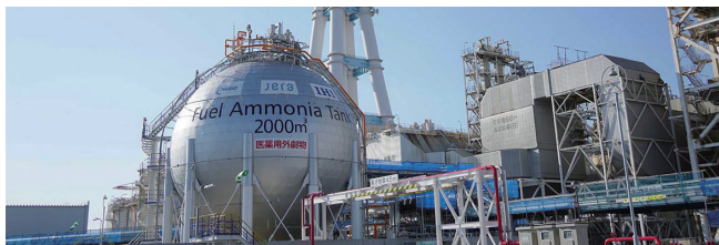
大規模実証試験のために新設した燃料アンモニアタンク
