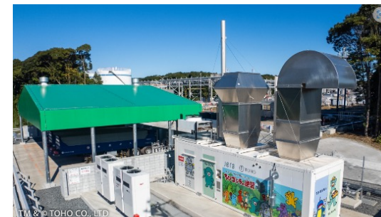
袖ヶ浦火力発電所(千葉県袖ヶ浦市)構内に設置した水素発電設備
