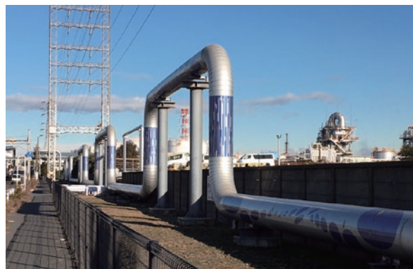
蒸気を供給する配管
