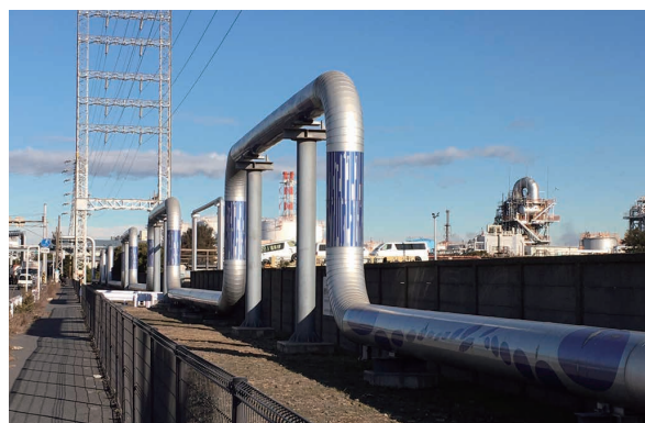
蒸気を供給する配管
