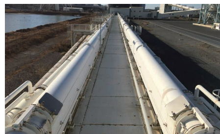
(左) 遮風フェンス (中) 貯炭場散水設備 (右) ベルトコンベア
