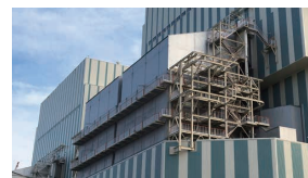
排煙脱硝装置(窒素酸化物(NOx)の除去)
