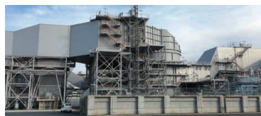
排煙脱硫装置(硫黄酸化物(SOx)の除去)
