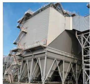
電気式集じん装置(ばいじんの除去)
