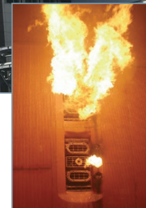
ボイラ燃焼状態
