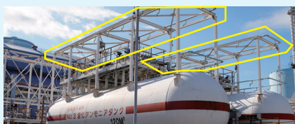
脱硝用アンモニアタンク
