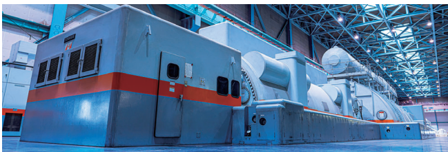
大規模混焼を予定する4号機のタービン・発電機
