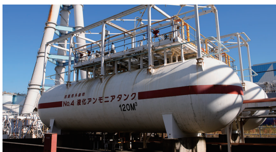
脱硝用アンモニア貯蔵タンク
