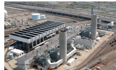
水素発電が可能になったリンデンガス火力発電所6号機(米国)
